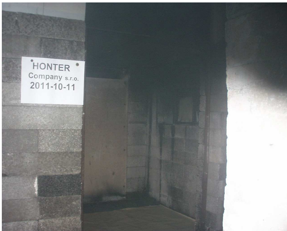
Pohled na zkušební vzorek č. 1 po zkoušce
